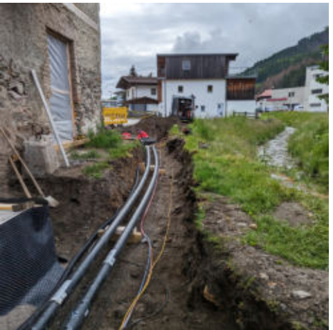
Anschluss an Fernwärme.
