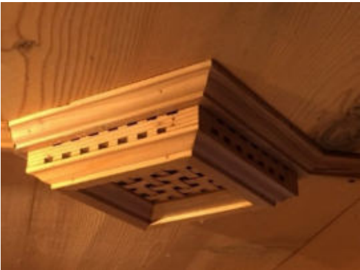
Bild oben: Deckenbelüftung mit seitlichen Luftaustritten
